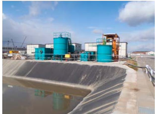
濁水処理プラント
