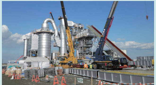
仮設焼却設備
