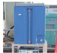
薬剤タンク、ポンプユニット
