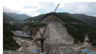
仮設設備の茶系塗装の状況
