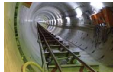
シールド工事における坑内のLED照明
