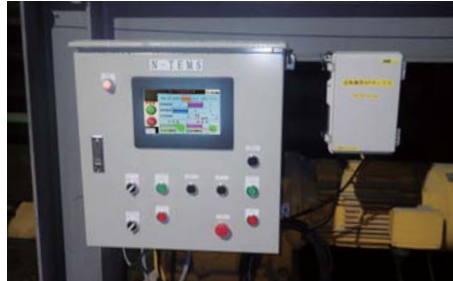
現場内に設置した操作盤
