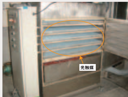
デモ機の設置状況
