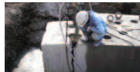
コンクリート破断状況
