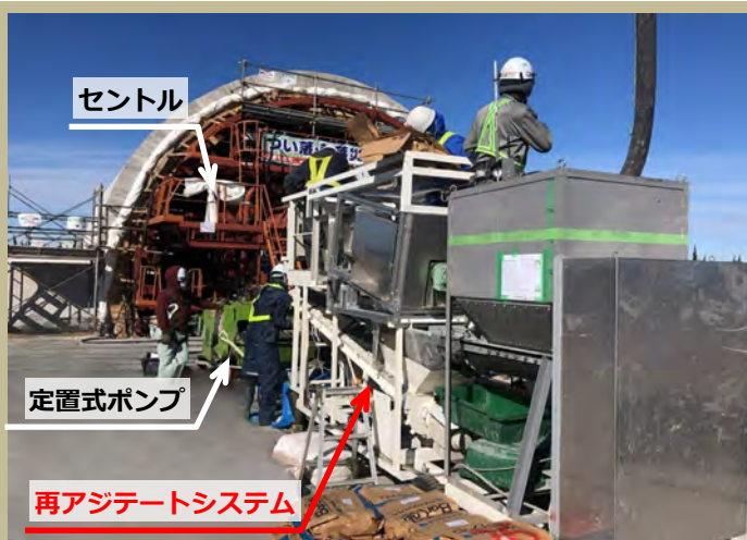
再アジテートシステムの稼働状況
