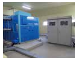
屋内設備: 発電機(左) および送電装置(右)
