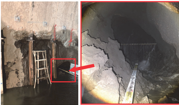
写真一七 水抜きボーリングによる側壁崩落状況
