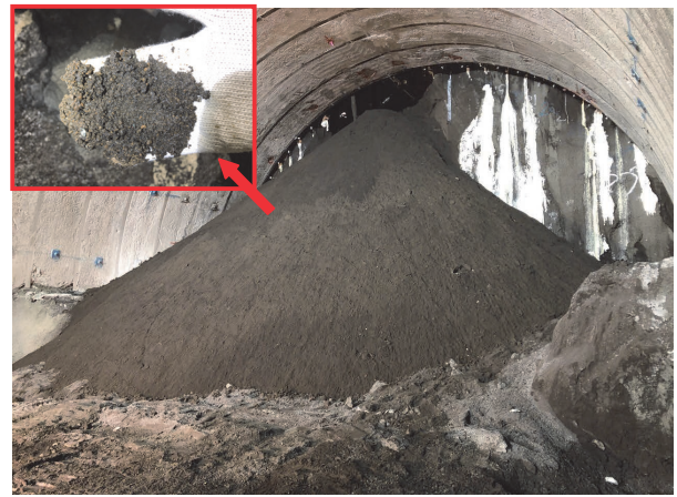
写真-1 天端崩落状況
