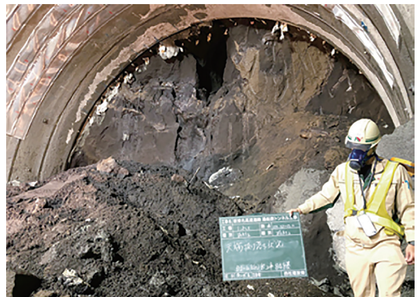
写真-2 切羽崩落状況
