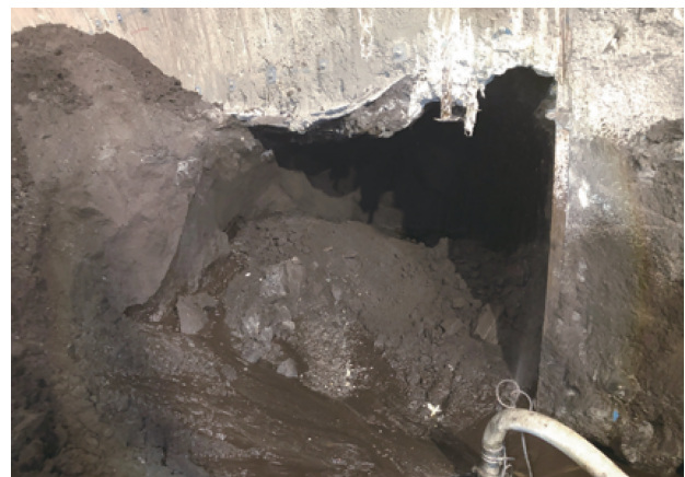
写真-5 下半切羽崩落・空洞状況
