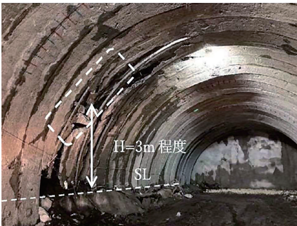
写真-9 下り線支保工変状状況
