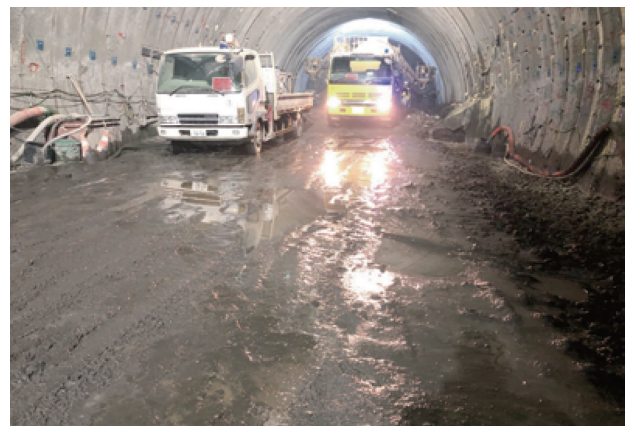
写真-6 路盤泥濁化状況
