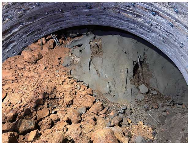
写真一1 崩落発生時の切羽写真（支保工 No.81）
