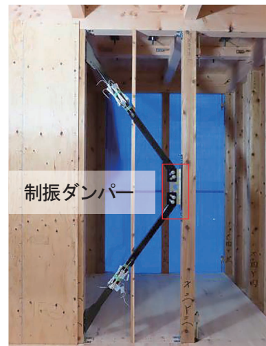
写真-2 制振ダンパー外観
