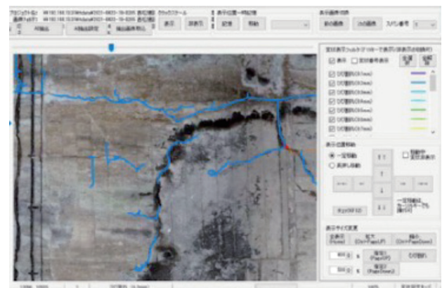
図一 4 AI ひび割れ検出ソフトによる結果例
