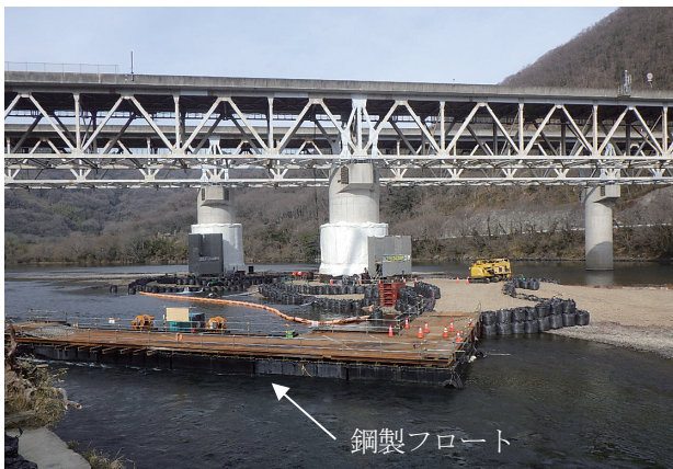
図一 鋼製フロート全景写真
