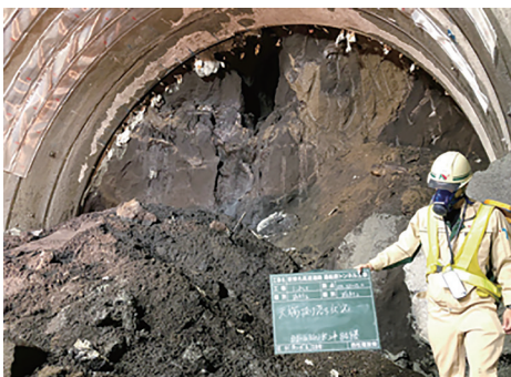
写真一 切羽崩落状況
