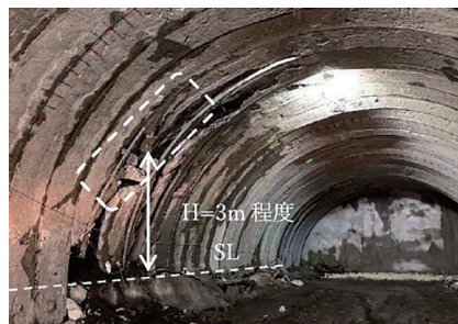
写真一 3 下り線支保工変状状況
