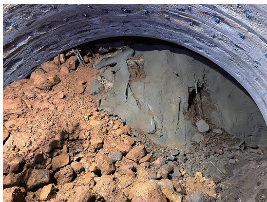
写真一 崩落時の切羽写真（支保工 No.81）
