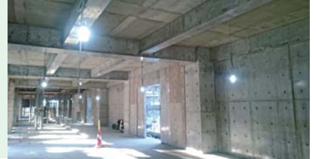
工所用仮設照明にLED照明使用
