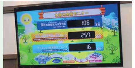
現場事務所に設置した太陽光発電モニター
