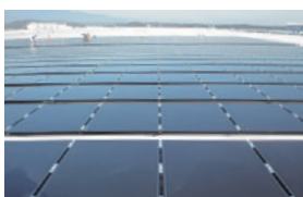
太陽光発電システム
