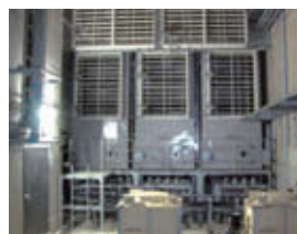
低濃度脱硝装置
