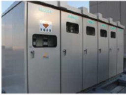
一括受電(受変電設備)
