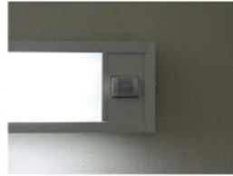
共用部の自動照明制御
