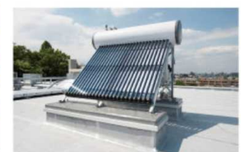
太陽光給湯システム
