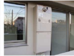
高効率給湯器(各住戸)
