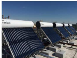
太陽光給湯システム
