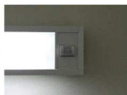
共用部の自動照明制御
