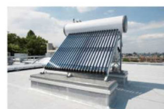
太陽光給湯システム
