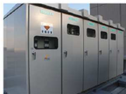
一括受電(受変電設備)
