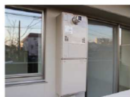
高効率給湯器(各住戸)
