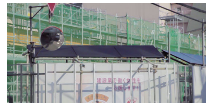
工所用仮囲いに太陽光パネルを設置
