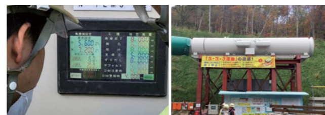
現場内に設置した操作盤
