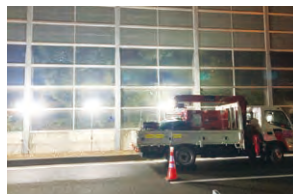
照明用発電機を用いたGTLと軽油の燃費性能を比較検証 (中部支店 勝川山田工事事務所)
