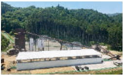
自然色に塗装したコンクリート製造設備 (北日本支社・川内沢ダム出張所)
