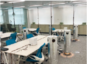
模擬負荷による空調性能試験
