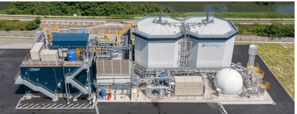
熊本西部バイオガス発電所
