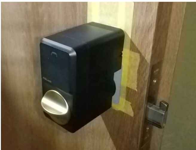
スマートロック設置状況
