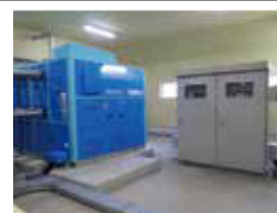
屋内設備： 発電機（左） および送変電装置（右）
