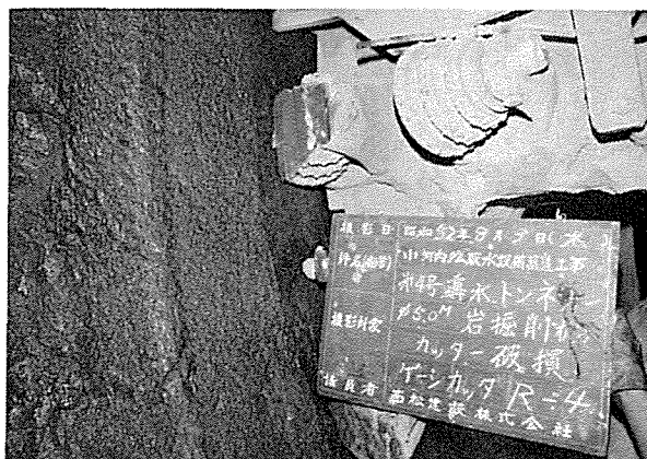
写真-5 カッター破損状況
