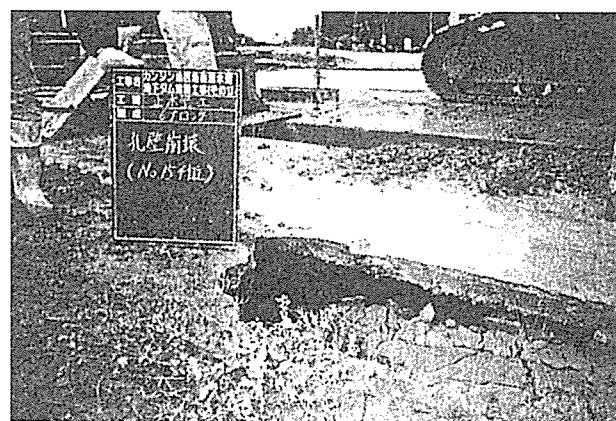
写真-1 ガイドウォール崩壊状況
