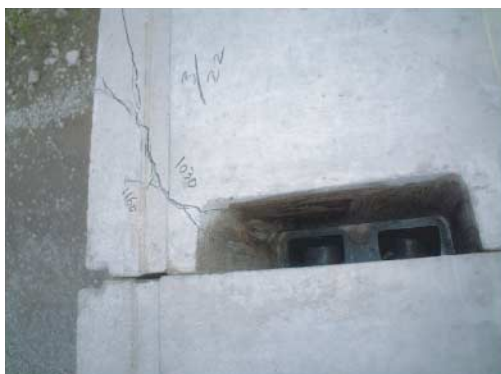
図-12 セン断試験クラック発生状況 (B-K)
