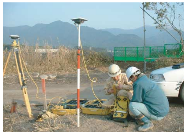
写真-2 基地局設置状況
