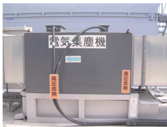
写真-3 電気集塵機
