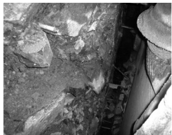
写真-5 前方崩落土固結状況
