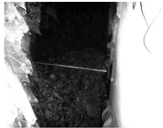
写真-4 切羽崩壊状況
