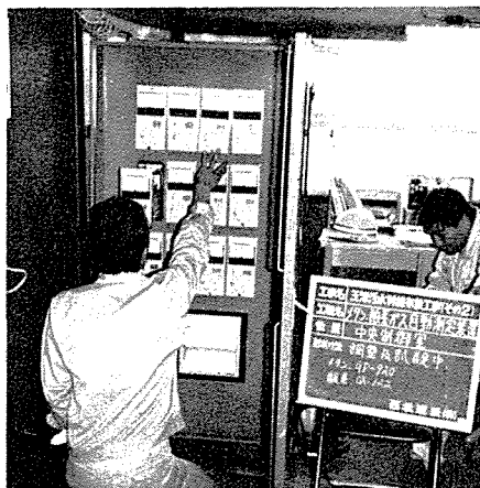
写真-7 ガス自動検知器中央監視盤
