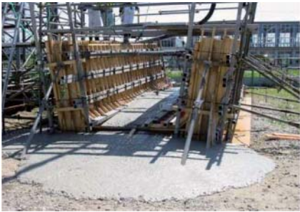
写真－2 コンクリートの流出状況
