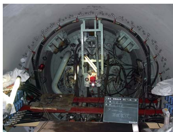
写真二 滑材注入装置（内部）
