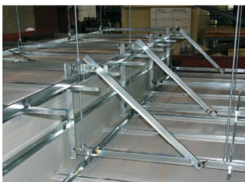
写真一5 段差部
