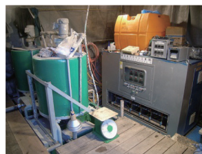
写真－1 注入プラント
