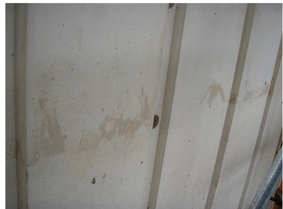
写真-6 コンクリート表面に生じた色むら
