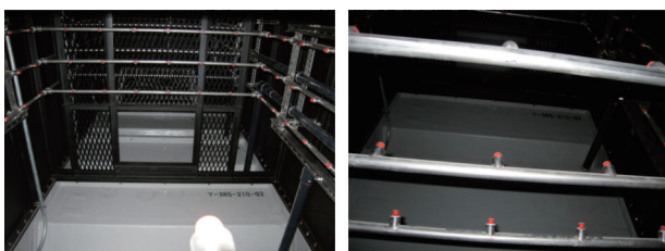
写真－1 現状ノズル設置状況
