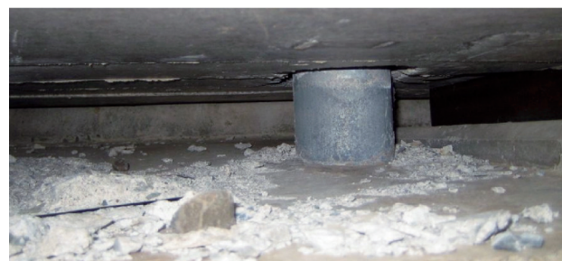
写真ー3 鋼棒ストッパー周囲の剥離
