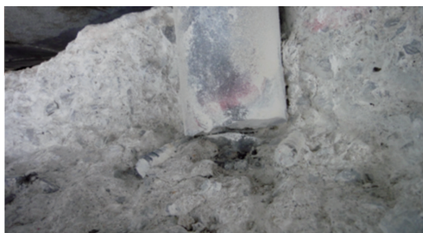
写真-5 鋼棒ストッパー (φ 90 mm) の破断 (1 km 862 m 50)
