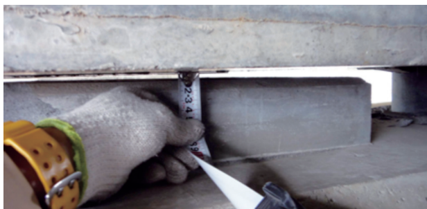
写真-8 ゴム沓脱落部の空間 (10 mm, 0 km 590 m 50)
