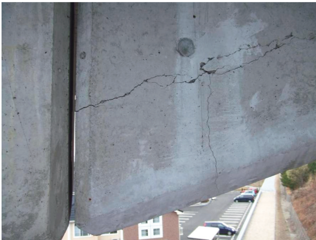
写真-10 上部工のひび割れ (2 km 794 m)
