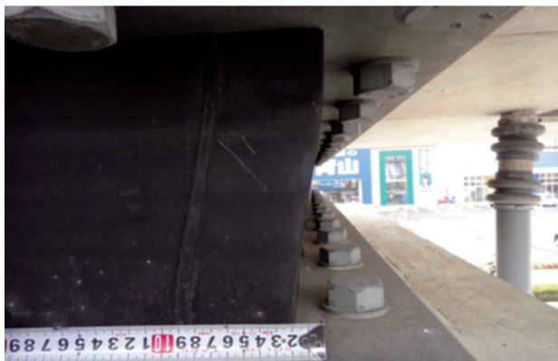
写真-9 ゴム沓の変形 (水平に 20 mm, 2 km 132 m)
