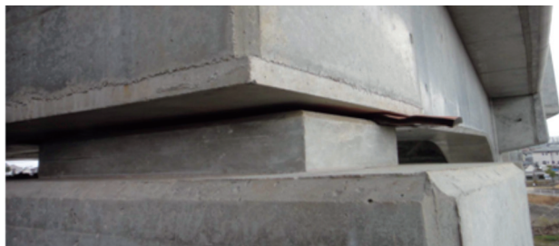
写真-6 ゴム沓の橋軸直角方向へのずれ (0 km 590 m 50)
