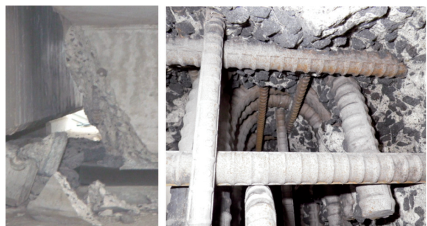
背面側の破損状況
