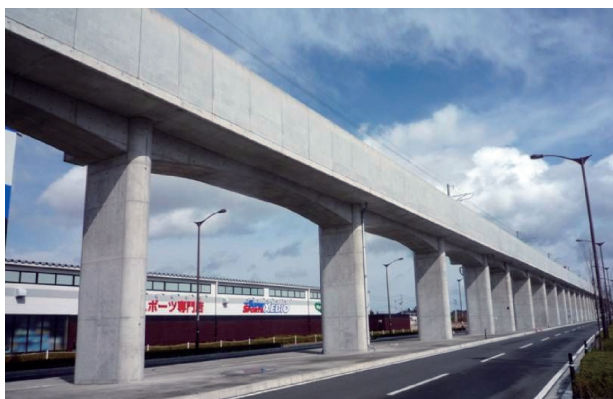
地震後の高架橋全景（2 km 500 m 付近）
