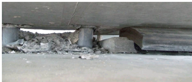
写真-7 ゴム沓の橋軸方向へのずれ (2 km 784 m)
