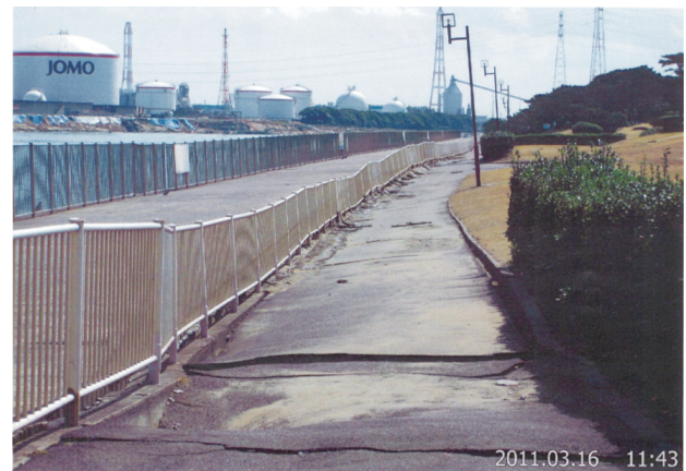
写真-7 ケーソン岸壁背面地盤沈下状況
