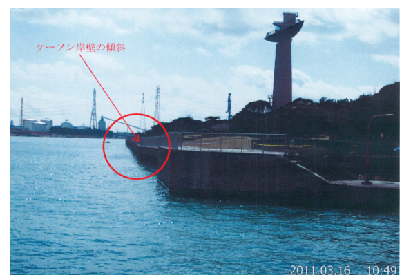
写真－6 ケーソン岸壁被災状況
