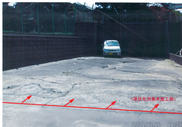
写真－5 岸壁背面被災状況
