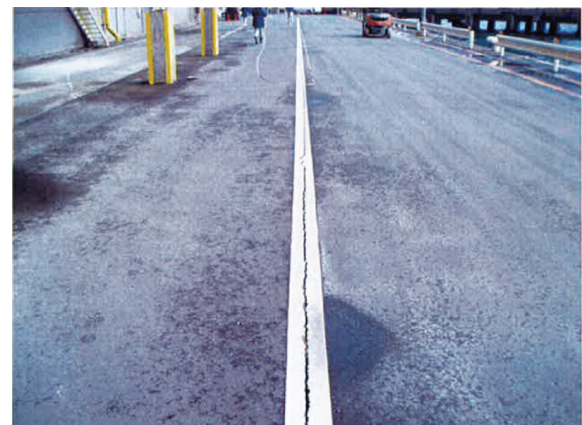
写真－4 岸壁背面 As 舗装クラック
