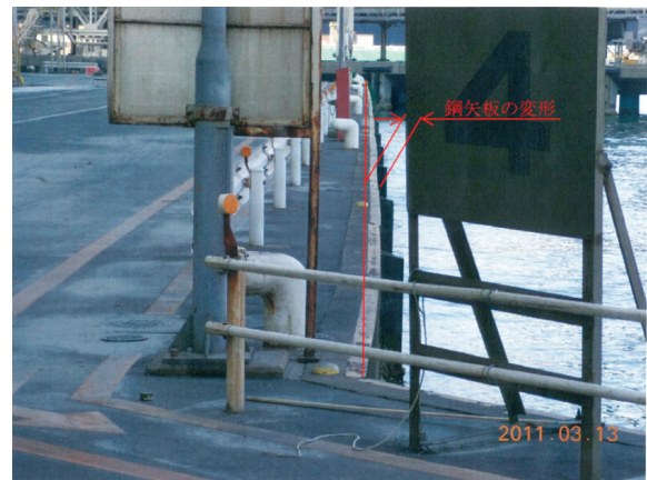
写真－3 岸壁頭部変形状況
