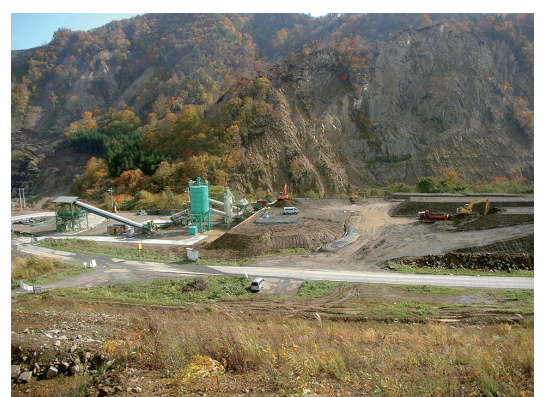
写真四 CSG混合設備
