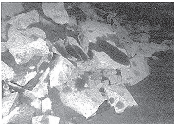
写真-1 山はね状況 (側壁部)
