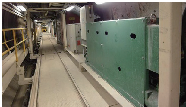
写真一 後方台車冷房装置
