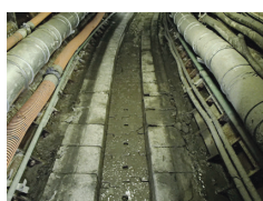
写真-9 インバート ブロック損傷状況
