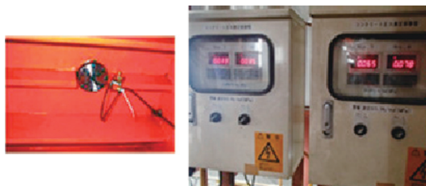
写真-1（左）圧力計（セントル内側より撮影） （右）圧力制御盤
