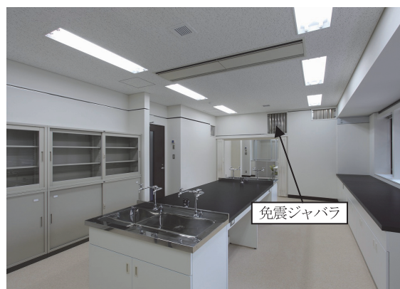
写真-9 免震ジャバラ
