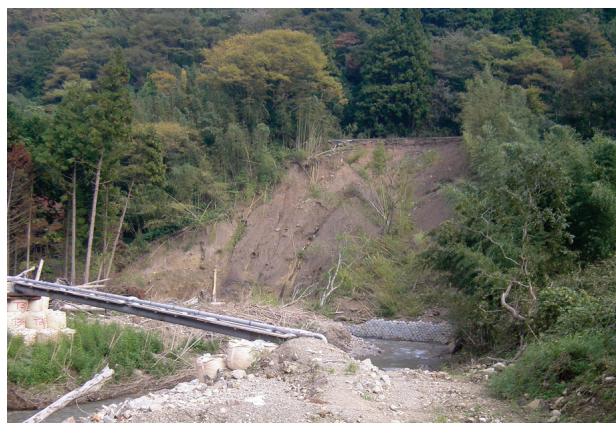
写真－1 着手前の被災状況
