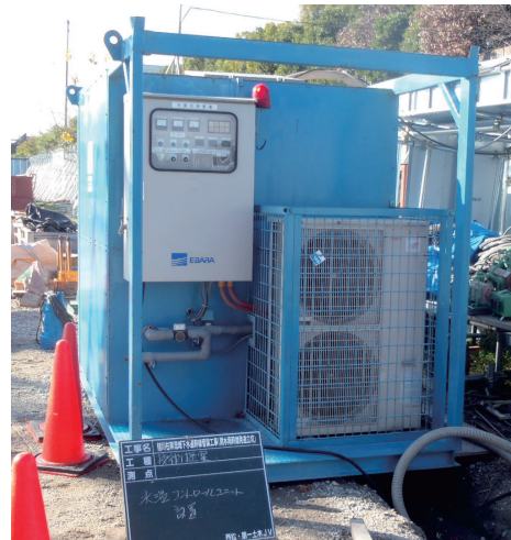
写真－2 水温コントロールユニット
